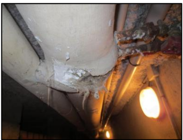
Photo N° 1061 ECH-N°2 CALORIFUGEAGE --COULOIRS DE CAVES Conduits de fluide Laine minérale + enveloppe plâtrée
